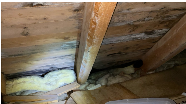
Svertesopp på undertak ned mot raft. Lufting ved raft tettet med mineralull.
