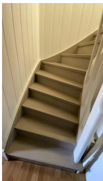
Trapp mellom 1. og 2. etg mangler håndløper på vegg.
