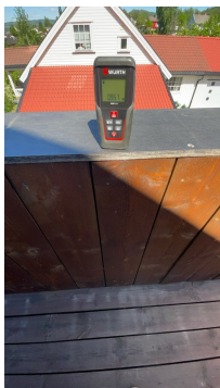
Rekkverkshøyde balkong i 2. etg. 95,7 cm.
