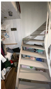
Deler av kjellertrapp mangler rekkverk.
