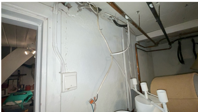
Løse ledninger i kjeller.
