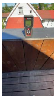
Rekkverkshøyde balkong i 2. etg. 95,7 cm.
