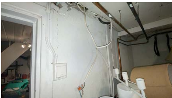
Løse ledninger i kjeller.
