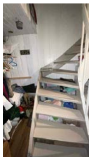
Deler av kjellertrapp mangler rekkverk.
