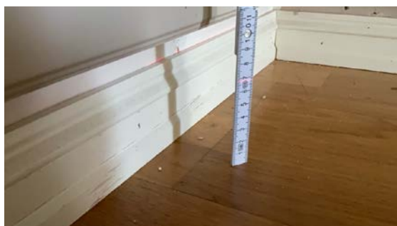
Gulv på kjøkken i hybel, mot innredning.
