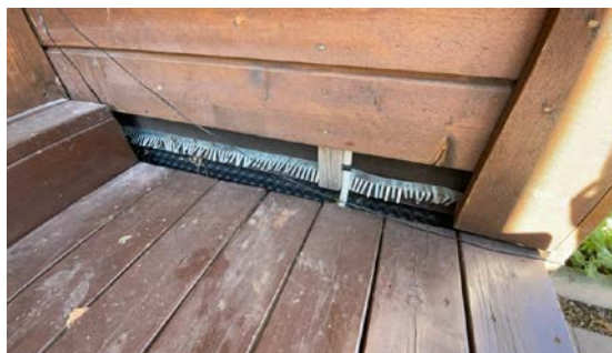
Nederste panelbord mangler.
