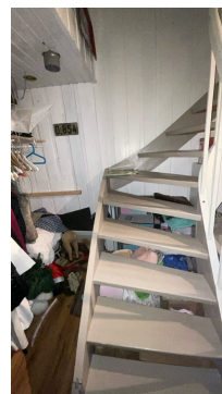
Deler av kjellertrapp mangler rekkverk.
