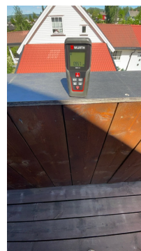
Rekkverkshøyde balkong i 2. etg. 95,7 cm.
