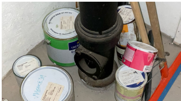
Stakeluke på soilrør i kjeller.
