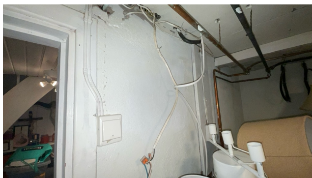
Løse ledninger i kjeller.
