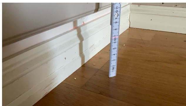
Gulv på kjøkken i hybel, mot innredning.
