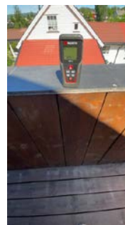
Rekkverkshøyde balkong i 2. etg. 95,7 cm.
