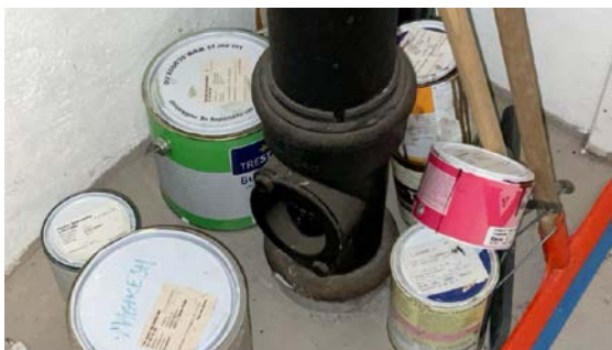
Stakeluke på soilrør i kjeller.
