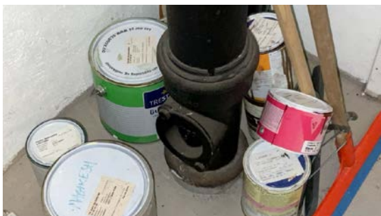
Stakeluke på soilrør i kjeller.
