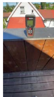
Rekkverkshøyde balkong i 2. etg. 95,7 cm.
