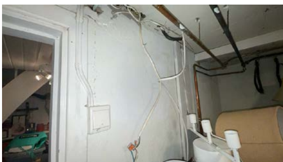
Løse ledninger i kjeller.
