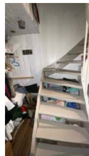
Deler av kjellertrapp mangler rekkverk.
