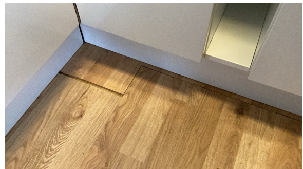
Laminatgulv skjøtet der hvor gammel kjøkkeninnredning har stått.
