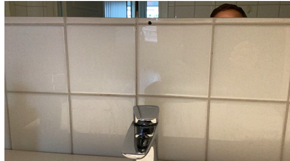
Sprekker i flis og fuge.
