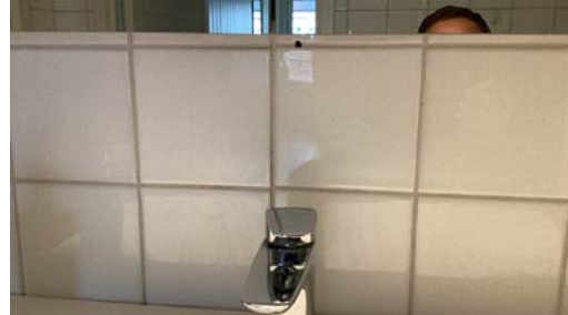
Sprekker i flis og fuge.
