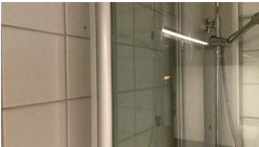
Hull i flisvegger
