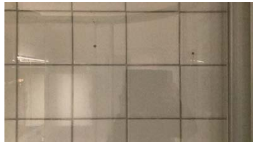
Hull i flisvegger
