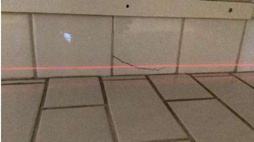
Sprekker i flis og fuge.
