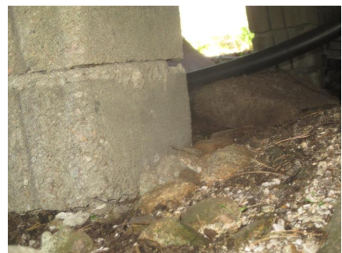
Masser er vasket vekk under enkelte pillarer.
