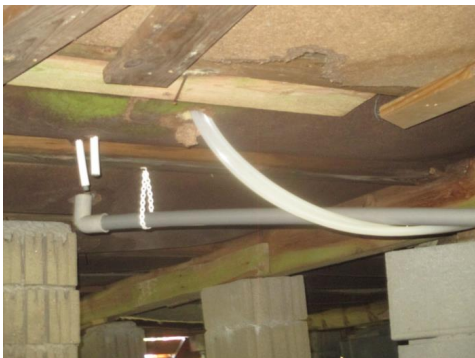
Deler av stubbloftet er skadet.-
