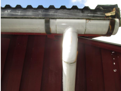
Deler av takrenner med nedløp. Noe rust på rennekroker.
