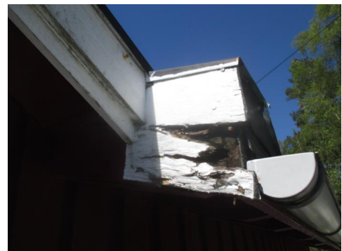
Mindre råteskadet vindski må byttes.
