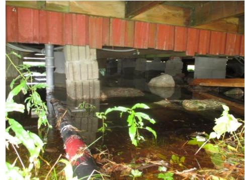
Større vannmengder under hytta. (Befaringen 19/9-23)
