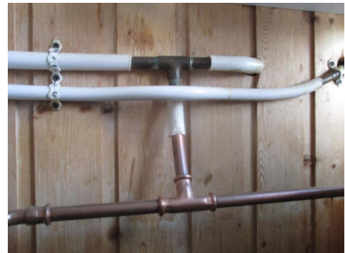
Kobberrør på teknisk rom.
