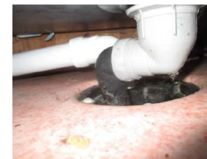
Sluk under dusjkabinett.
