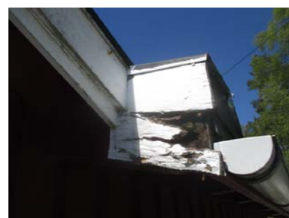
Mindre råteskadet vindski må byttes.
