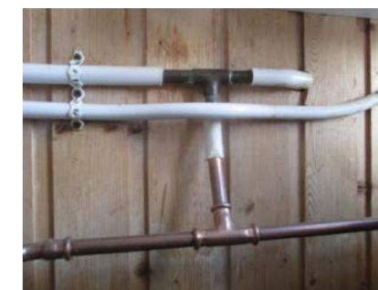
Kobberrør på teknisk rom.
