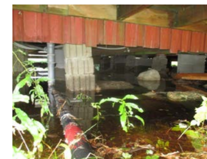
Større vannmengder under hytta. (Befaringen 19/9-23)
