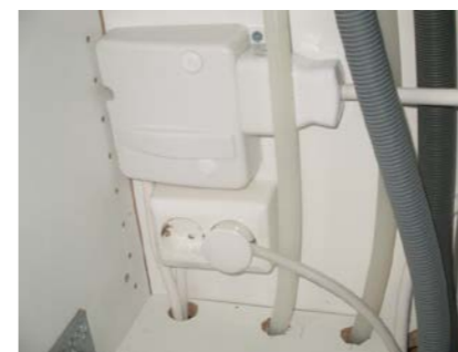
Plastrør i kjøkkenbenken.
