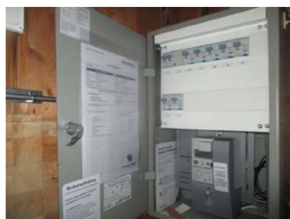
Sikringsskapet er plassert på teknisk rom.
