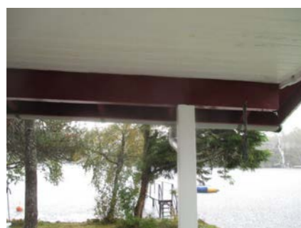
En del sig i takutstikk ut i fra stue.
