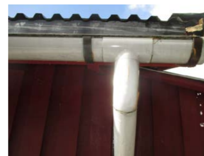
Deler av takrenner med nedløp. Noe rust på rennekroker.
