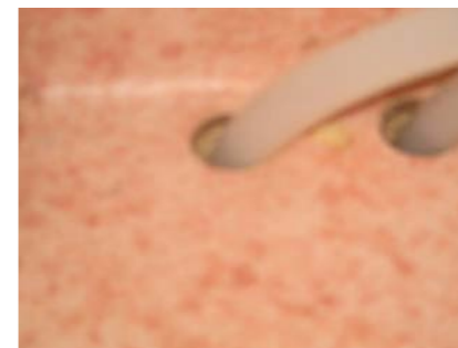
Hull i belegget ved rørgjennomføringer.
