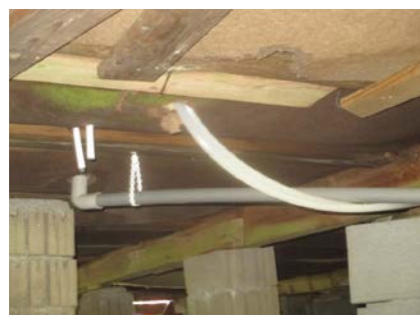
Deler av stubbloftet er skadet.-
