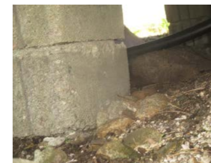
Masser er vasket vekk under enkelte pillarer.
