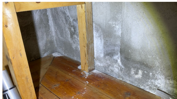
Saltutslag på vegg.
