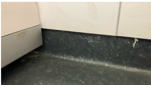
Manglende tetting i nedre kant av våtromsplater.
