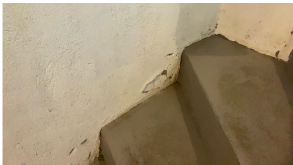
Fuktmerker i trapp til kjeller.
