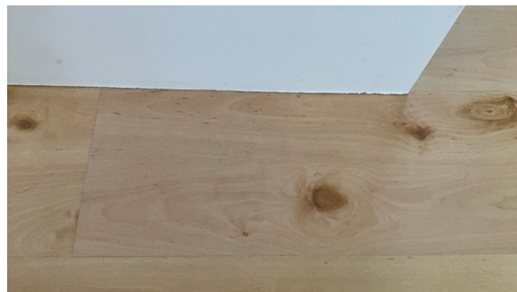
Noe fuktsvelling på innredning etter lekkasje fra bereder.
