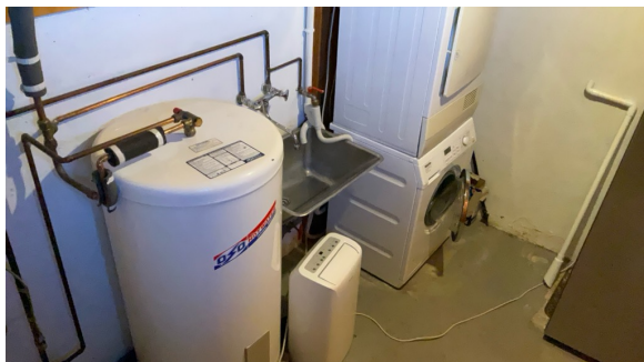
Vaskerom med vask, bereder og opplegg til vaskemaskin
