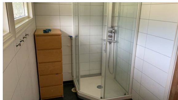
Dusjkabinett og opplegg til vaskemaskin.
