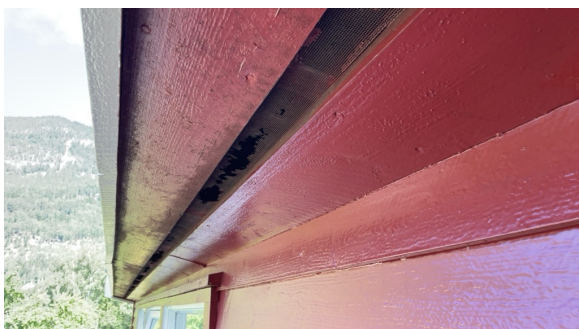
Defekt fluenetting i gesims.
