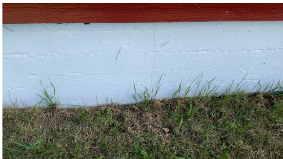
Sprekk i grunnmur.
