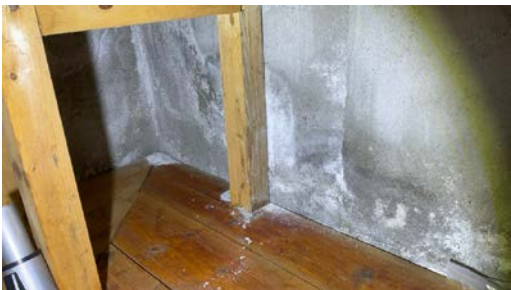
Saltutslag på vegg.
