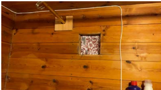
Ventil i vegg er tettet.
