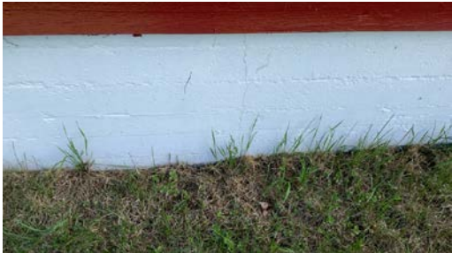
Sprekk i grunnmur.
