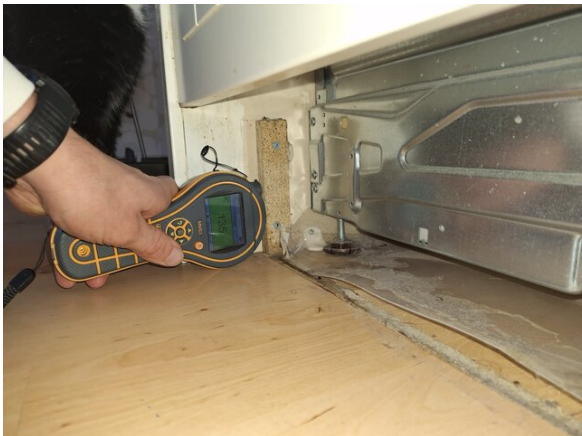
Indikerer ikke unormal fukt på dekkside
