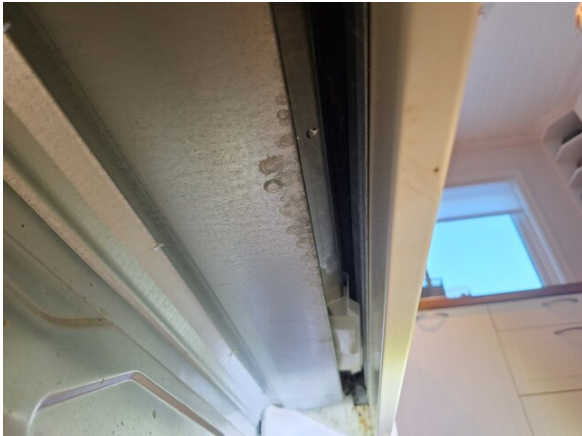
Oppvaskmaskin ble testet under befaring og til slutt ble det påvist lekkasje mellom dør og maskinen
