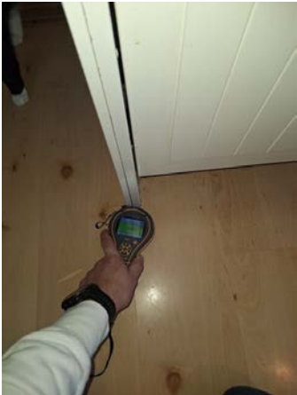
Indikerer ikke unormal fukt på kjøkkengulv
