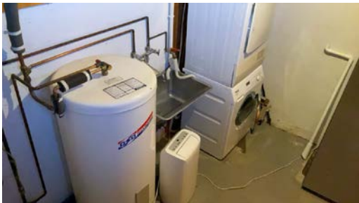
Vaskerom med vask, bereder og opplegg til vaskemaskin
