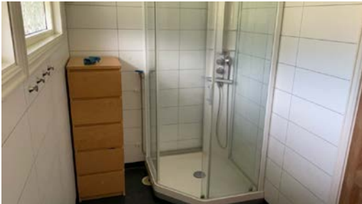
Dusjkabinett og opplegg til vaskemaskin.
