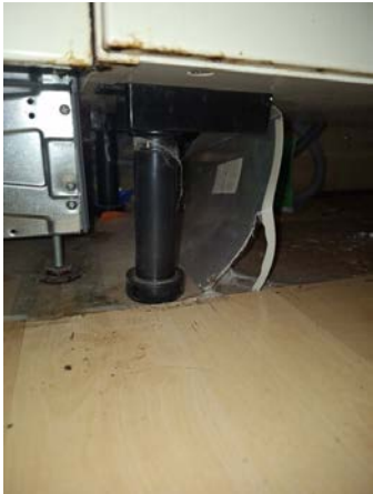
Plastunderlag leder ut til under sokkel hvor laminat på kjøkkengulv stopper.
