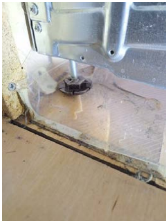
Ser det står litt vann klemt mellom gulv og underlag under oppvaskmaskinen.
