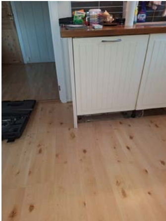
Oversikt oppvaskmaskin og hvor det var fuktig
