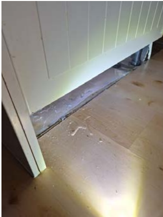
Oppvaskmaskin ble testet under befaring og til slutt ble det påvist lekkasje mellom dør og maskinen
