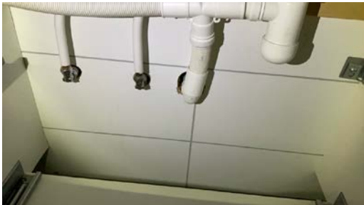
Utett rundt rørgjennomføring i vegg.
