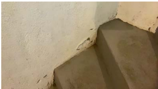
Fuktmerker i trapp til kjeller.
