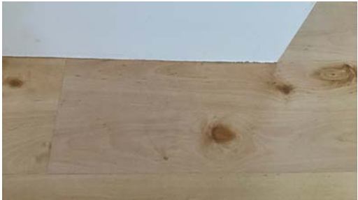
Noe fuktsvelling på innredning etter lekkasje fra bereder.
