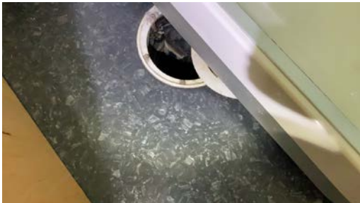
Plastsluk ved dusjkabinett.
