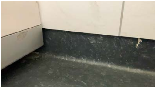
Manglende tetting i nedre kant av våtromsplater.
