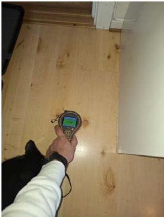
Indikerer ikke unormal fukt på kjøkkengulv
