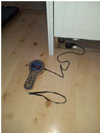
Måler forhøyet verdi på laminatgulv som ligger under oppvaskmaskinen
