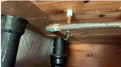
Noe irr på vannrør i kjeller.
