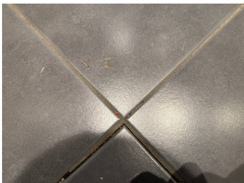
Sprekker og delvis løse gulvfliser i entre.
