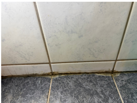
Sprekker i veggfliser i nedre del av dusjsone.
