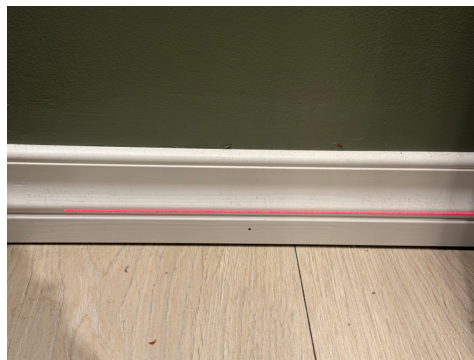
Bilder viser skjevheter i gulv på kjøkken.
