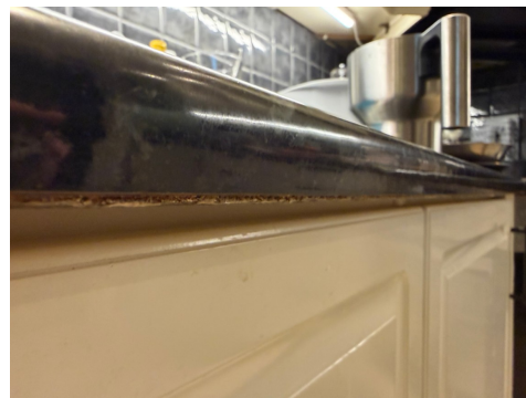
Fuktutsvelling på underside av benkeplate.
