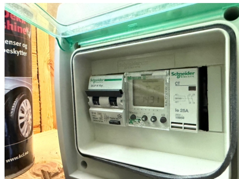
Sikringsboks i bod med utvendig adkomst.
