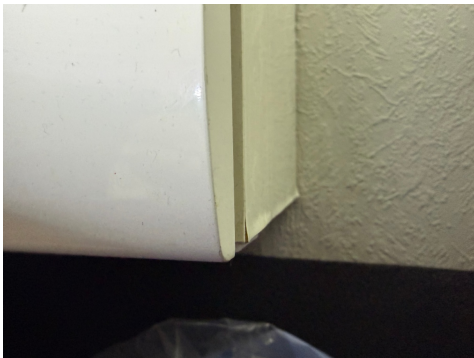
Fuktutsvelling i nedre del av baderomsinnredning.
