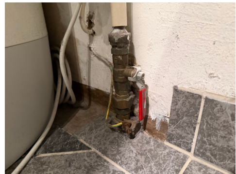
Stoppekran på vaskerom.
