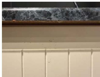
Fuktutsvelling på underside av benkeplate v/ vask.
