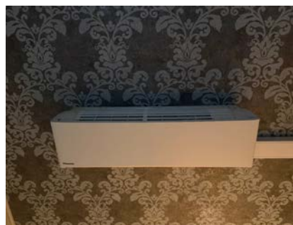
Varmepumpe med uttak i trapperom
