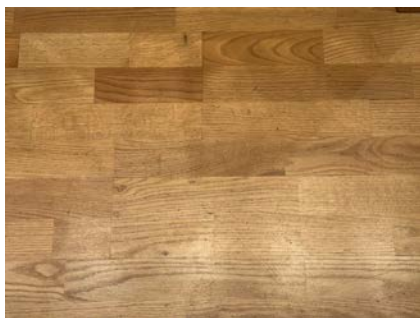
Slitasje/striper i parkettgulv.
