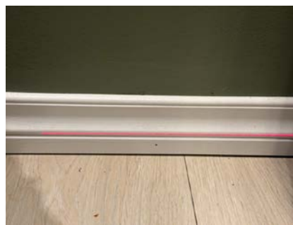
Bilder viser skjevheter i gulv på kjøkken.
