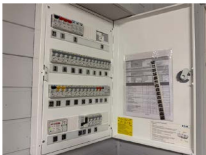
Sikringsskap i tv-stue/hobbyrom.
