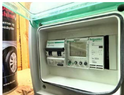
Sikringsboks i bod med utvendig adkomst.
