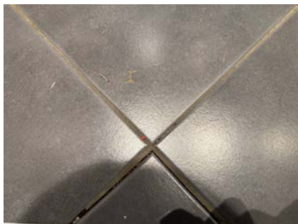
Sprekker og delvis løse gulvfliser i entre.
