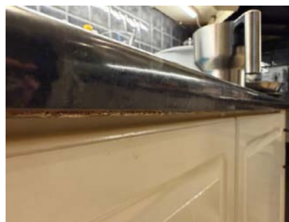
Fuktutsvelling på underside av benkeplate.
