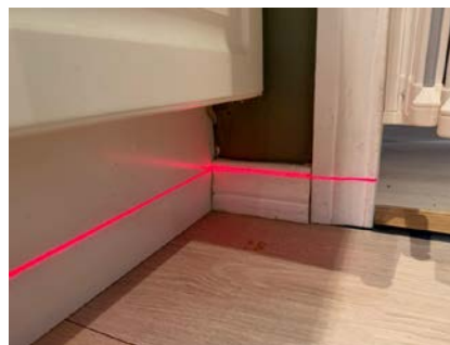
Bilder viser skjevheter i gulv på kjøkken.
