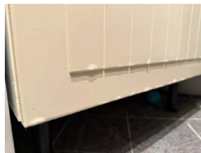
Fuktutsvelling i nedre del av skapfront.
