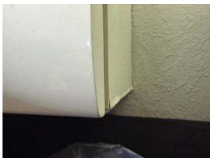
Fuktutsvelling i nedre del av baderomsinnredning.
