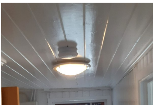
Røykvarsler i 1. etasje
