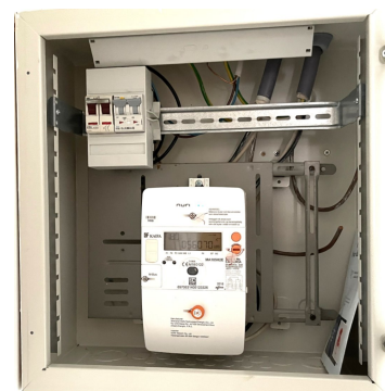
Sikringsskap med AMS-måler i 1. etasje
