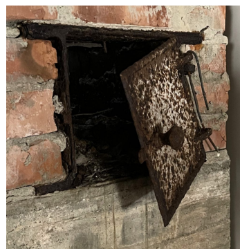
Defekt og rusten feieluke i underetasje
