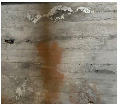
Saltutslag på innsiden av grunnmur
