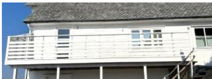
For store åpninger i øvre del av altanrekkverk mot syd.
