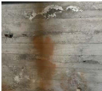
Saltutslag på innsiden av grunnmur
