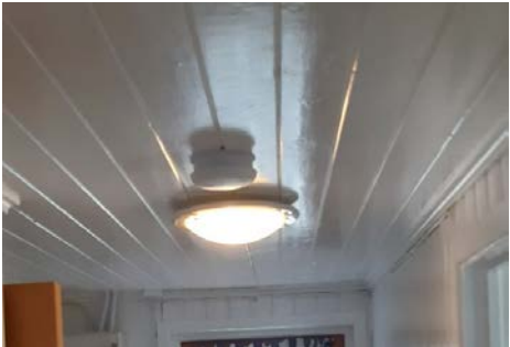
Røykvarsler i 1. etasje
