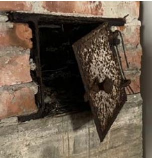
Defekt og rusten feieluke i underetasje
