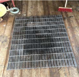
Galvanisert stålrister over luke i gulv i underetasje.
