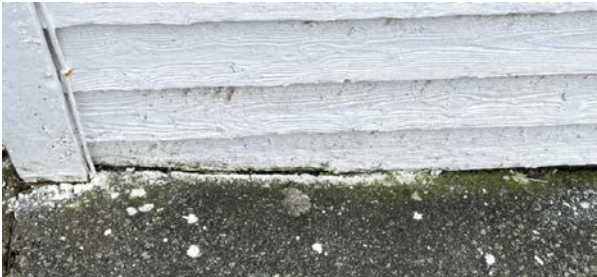
Liten og ingen avstand mellom kledning og terreng mot nord.
