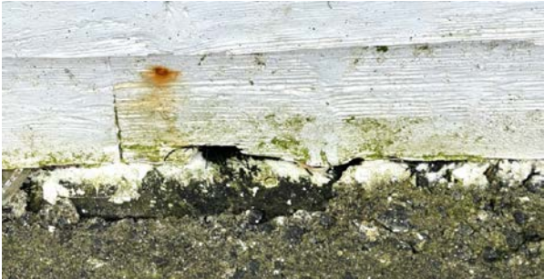
Liten og ingen avstand mellom kledning og terreng mot nord.
