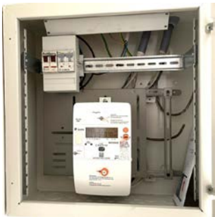
Sikringsskap med AMS-måler i 1. etasje
