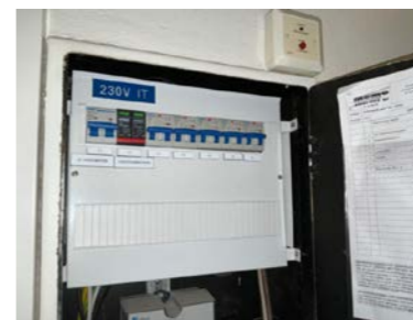
Automatsikringer i sikringskap plassert i gang/fellesareal.
