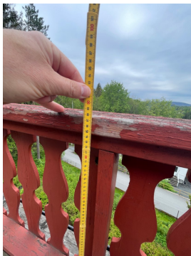
Rekkverk veranda under 100 cm
