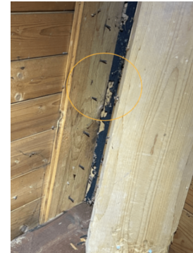
Undertaksbelegg med brudd i møne
