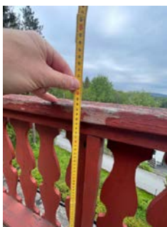
Rekkverk veranda under 100 cm
