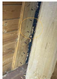
Undertaksbelegg med brudd i møne
