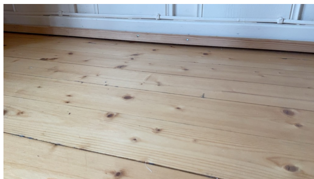
Bemerket glippe mellom gulv/gulvlist
