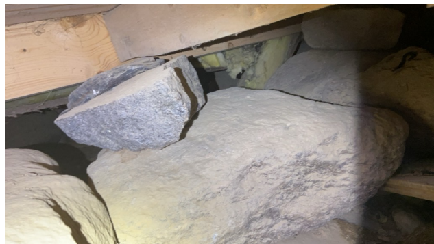
Synlig aktivitet/skade i osolasjon fra mus/skadedyr
