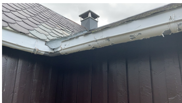
Slitasje på renner, ikke egnet skjøt med benyttet teip i overgang til grad
