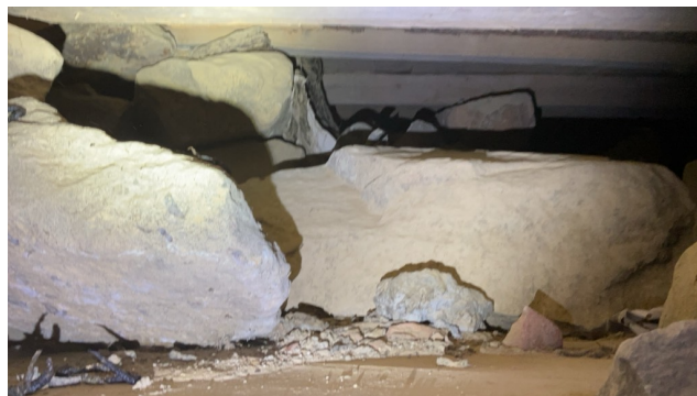
Gulvkonstruksjon er uisolert
