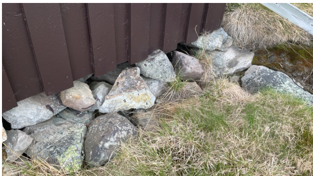
Gjennomgang av mur bør foretas
