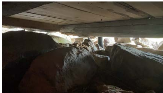
Manglende mur/steiner under hjørne på hytte, må foretas tiltak og undersøkelse av mur i sin helhet
