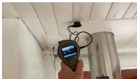
Avflassing av maling, ved fuktmåletaking rundt pipestamme var det ikke fuktutslag
