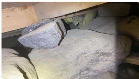
Synlig aktivitet/skade i osolasjon fra mus/skadedyr
