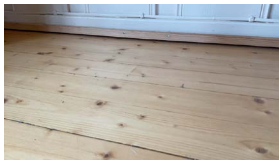
Bemerket glippe mellom gulv/gulvlist
