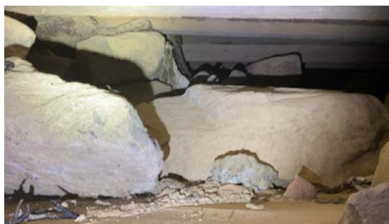
Gulvkonstruksjon er uisolert
