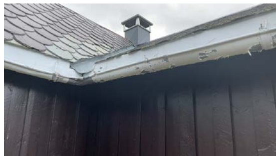
Slitasje på renner, ikke egnet skjot med benyttet teip i overgang til grad
