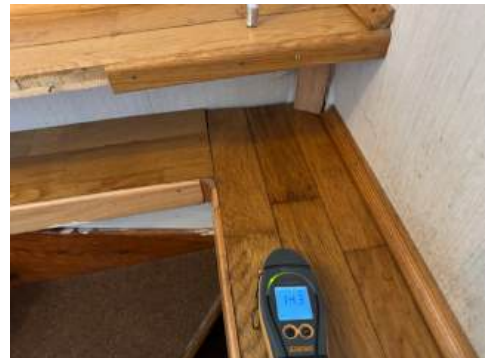
Skjevheter i overgang v/ innvendig trapp. Ingen forhøyede fuktverdier ble registrert i det aktuelle område.
