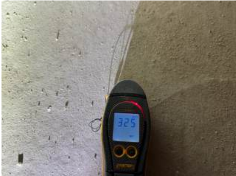
Forhøyede fuktverdier i betonggulv.
