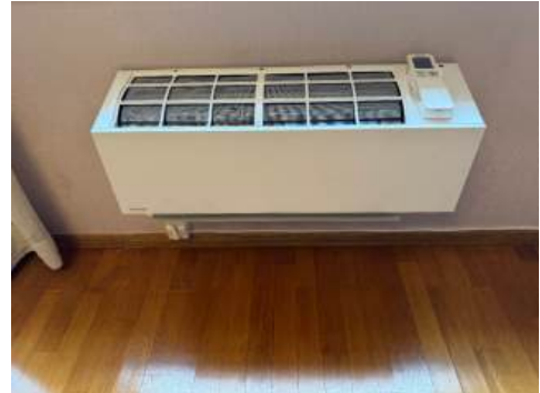
Varmepumpe med uttak i stue.
