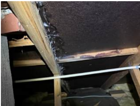
Fukt/lekkasje rundt pipe, synlig på koffertloft.
