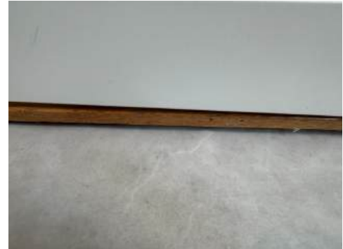
Ingen oppbrett på våtromsbelegg v/ døråpning.
