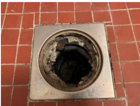
Eldre plastsluk i dusjsone. Ingen tegn til tettesjikt/membran i sluk.
