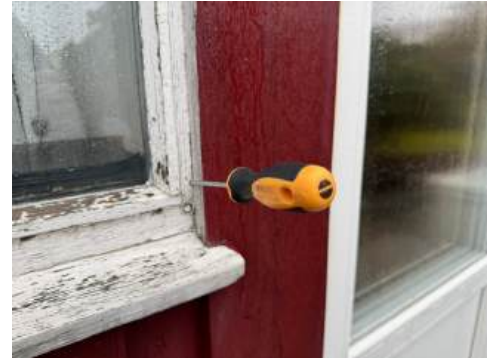
Råte i stuevindu i endevegg.
