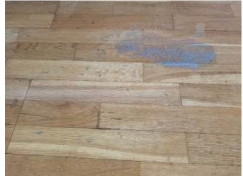
Slitasje i parkettgulv i stue.
