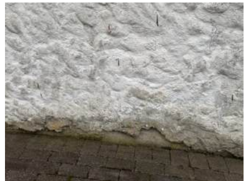
Manglende puss i nedre del av grunnmur.
