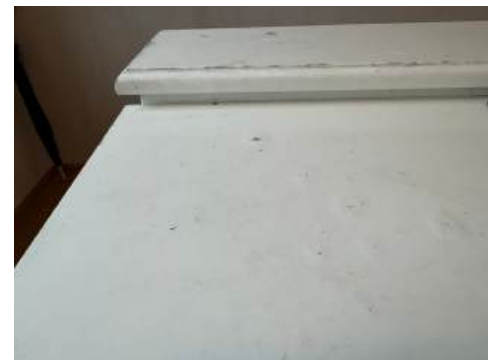
Svelling/slitasje på benkeplate.
