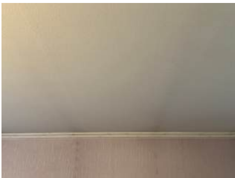
Støvkondens/heksesot på overflater i stue.
