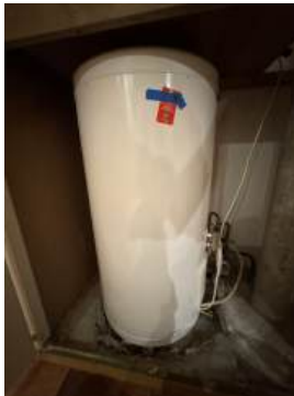
Varmtvannstank i skap i gang i u-etg
