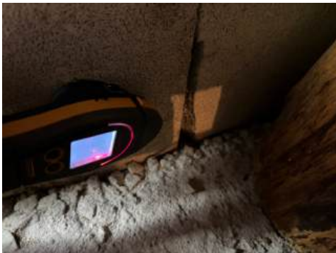
Forhøyede fuktverdier i nedre del av grunnmur i bod. Det kan skyldes fuktvandring i grunnmur, ev. kapilærøpsug fra grunn.
