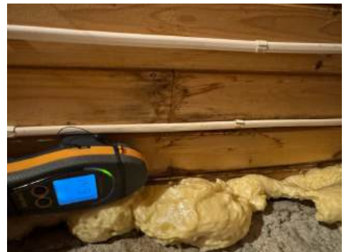
Eldre fuktmerker i bodhimling i u-etg. Ingen forhøyede fuktverdier ble registrert i det aktuelle område.
