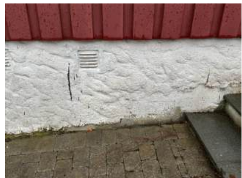
Manglende puss i nedre del av grunnmur.
