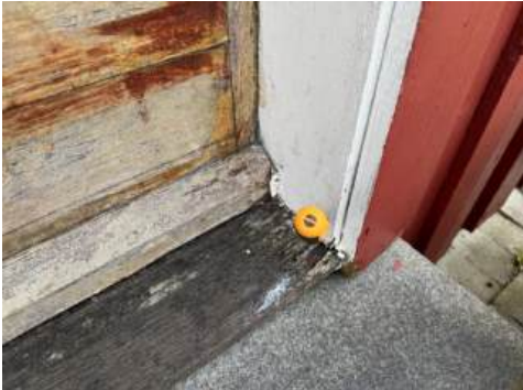
Råte i karm på hovedytterdør.
