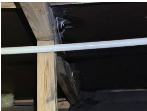
Fukt/lekkasje rundt pipe, synlig på koffertloft.
