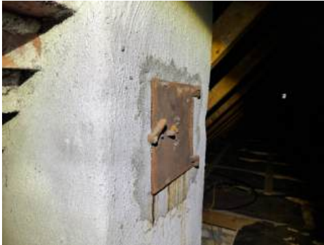
Rust på feilsluke på koffertloft.
