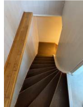
Ingen håndløper på vegger i trappeløp.
