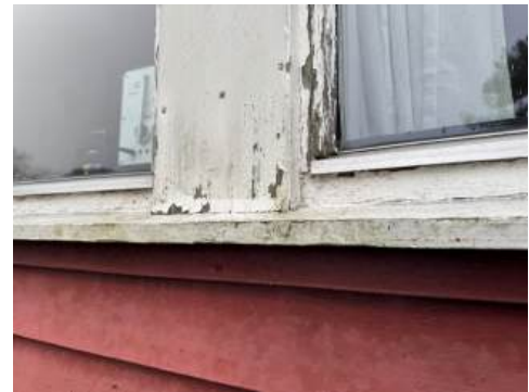
Slitasje og begynnende råte i stuevinduer i front.
