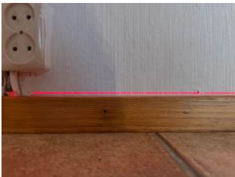
Bilder viser skjevheter i gulv i kjellerstue.
