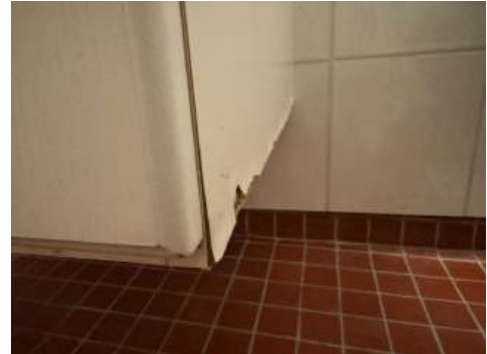
Fuktutsvelling i nedre del av baderomsinnredning.
