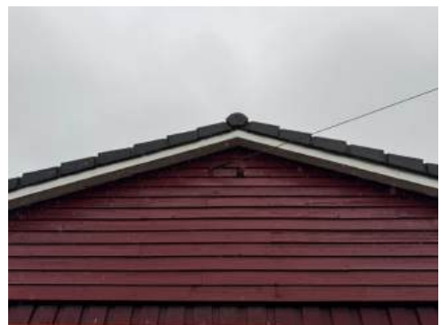
Værroppsprukket/slitt kledning på endevegg.
