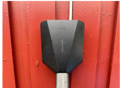
El. bil ladestasjon på yttervegg.
