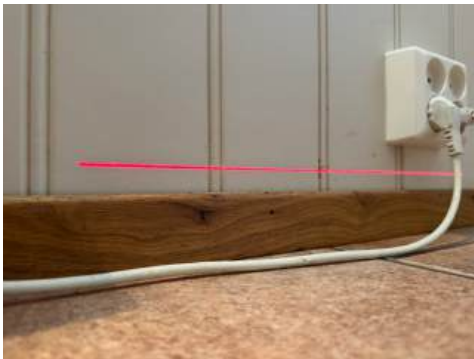
Bilder viser skjevheter i gulv i kjellestue.
