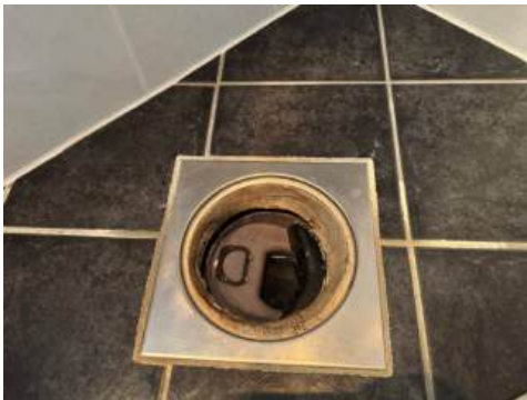
Plastsluk i dusjsone.
