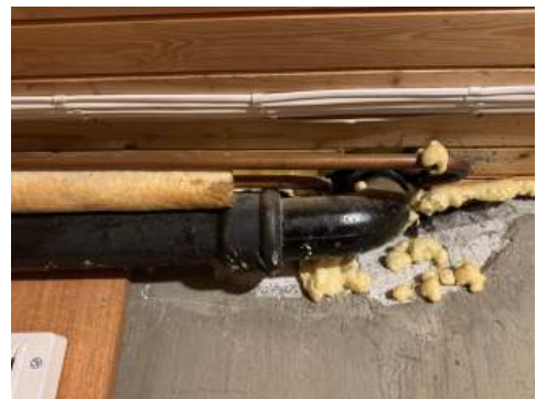
Eldre støpejernsrør i u-etg.
