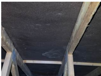
Eldre fuktmerker i sutak.
