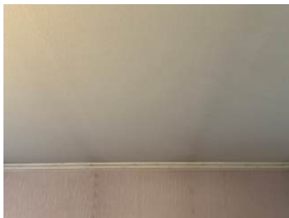
Støvkondens/heksesot på overflater i stue.
