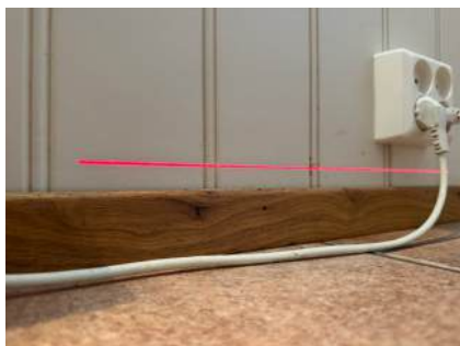
Bilder viser skjevheter i gulv i kjellestue.
