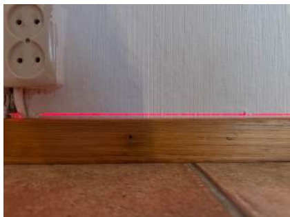
Bilder viser skjevheter i gulv i kjellerstue.
