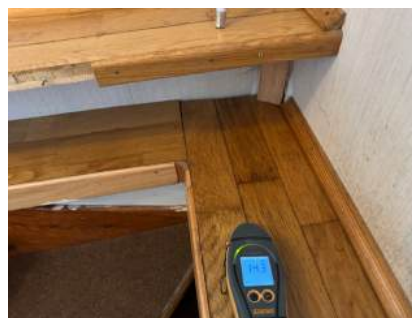
Skjevheter i overgang v/ innvendig trapp. Ingen forhøyede fuktverdier ble registrert i det aktuelle område.
