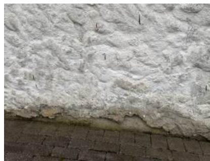
Manglende puss i nedre del av grunnmur.
