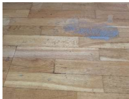
Slitasje i parkettgulv i stue.
