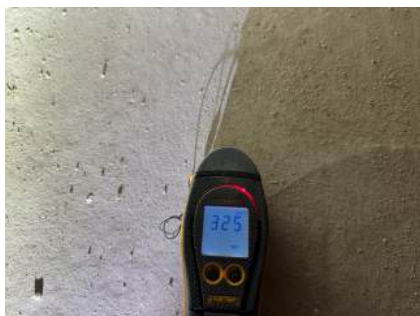
Forhøyede fuktverdier i betonggulv.
