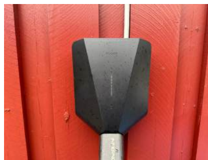
El. bil ladestasjon på yttervegg.
