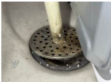
Plastsluk i gulv. Ujevnheter i våtromsbelegg mellom vegg - sluk.
