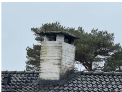
Pipe utvendig. Det ble oppdaget lekkasje rundt pipe på befaringdagen.
