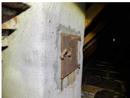
Rust på feieluke på koffertloft.
