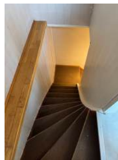
Ingen håndløper på vegger i trappeløp.
