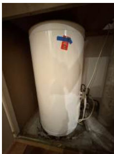
Varmtvannstank i skap i gang i u-etg
