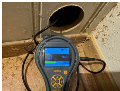
Måling av trefukt/vektprosent.
