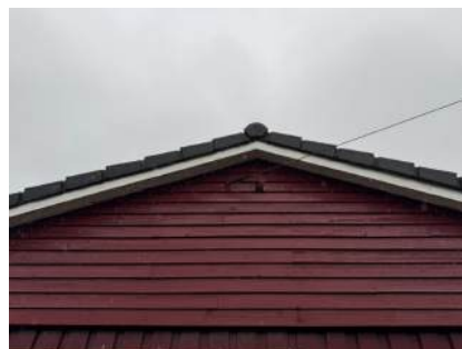
Værøppsprukket/slitt kledning på endevegg.
