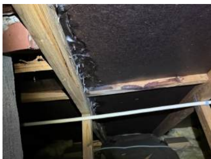
Fukt/lekkasje rundt pipe, synlig på koffertloft.
