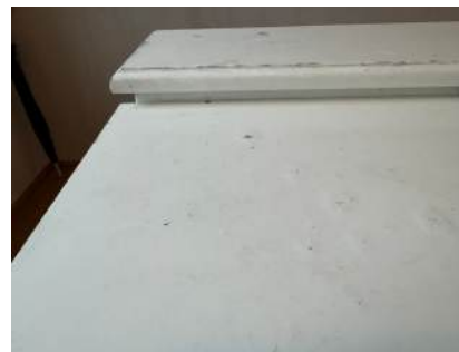
Svelling/slitasje på benkeplate.
