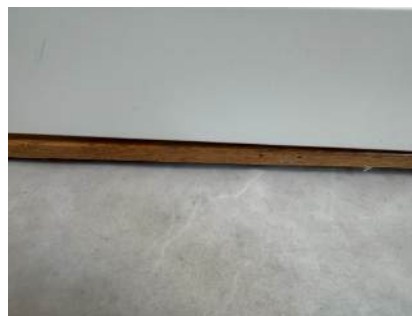
Ingen oppbrett på våtromsbelegg v/ døråpning.
