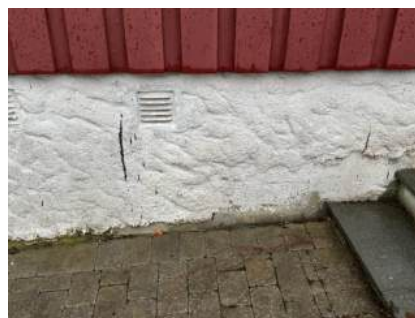
Manglende puss i nedre del av grunnmur.
