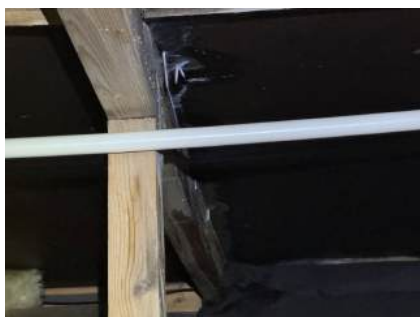
Fukt/lekkasje rundt pipe, synlig på koffertloft.
