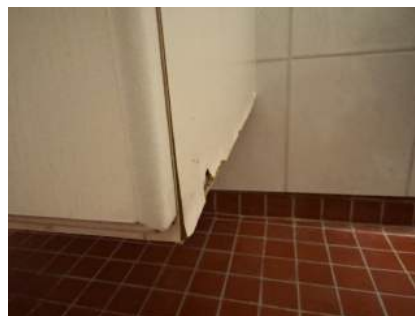
Fuktsvelling i nedre del av baderomsinnredning.
