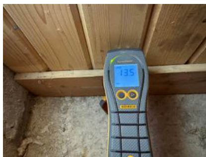
Måling av trefukt/vektprosent.
