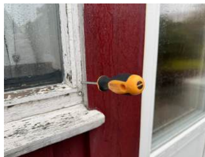
Råte i stuevindu i endevegg.
