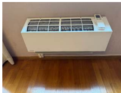
Varmepumpe med uttak i stue.
