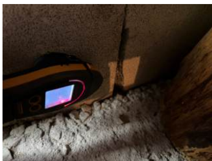
Forhøyede fuktverdier i nedre del av grunnmur i bod. Det kan skyldes fuktvandring i grunnmur, ev. kapilær oppsug fra grunn.
