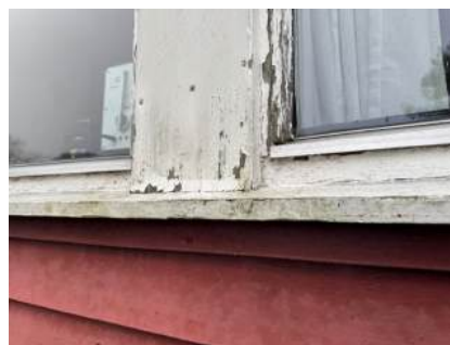
Slitasje og begynnende råte i stuevinduer i front.
