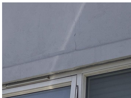
Sprekker i murpuss.
