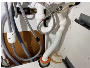
Merker etter vann i bunn på benkeskap.
