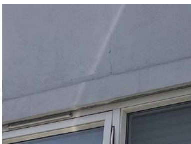
Sprekker i murpuss.
