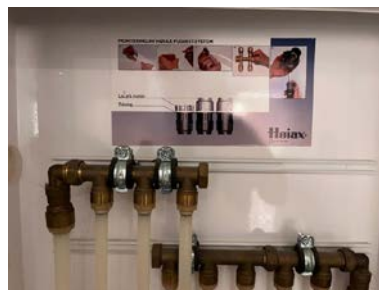
Rørkurser er ikke merket
