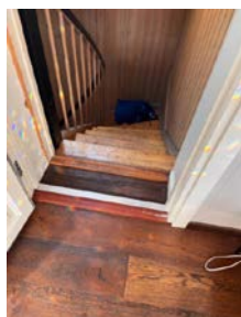
Ytterdør på loftetasjen har lav frihøyde.
