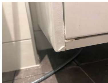
Fuktsvelling på skapskrog
