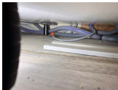
Ikke vannstoppesystem under kjøkkenbenk
