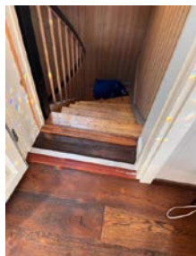
Ytterdør på loftetasjen har lav frihøyde.
