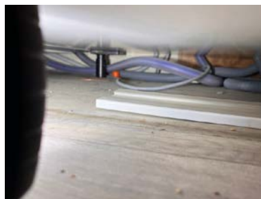
Ikke vannstoppesystem under kjøkkenbenk
