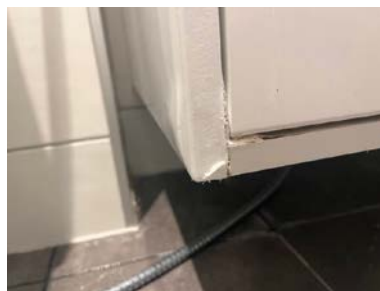
Fuktsvelling på skapskrog
