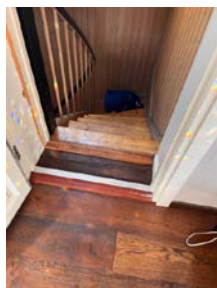
Ytterdør på loftetasjen har lav frihøyde.
