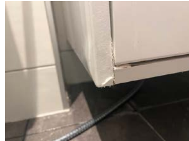
Fuktsvelling på skapskrog
