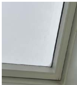
Kondens og merker etter kondensvann på takvindu
