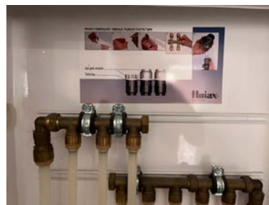
Rørkurser er ikke merket
