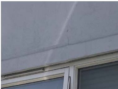
Sprekker i murpuss.
