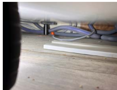
Ikke vannstoppesystem under kjøkkenbenk
