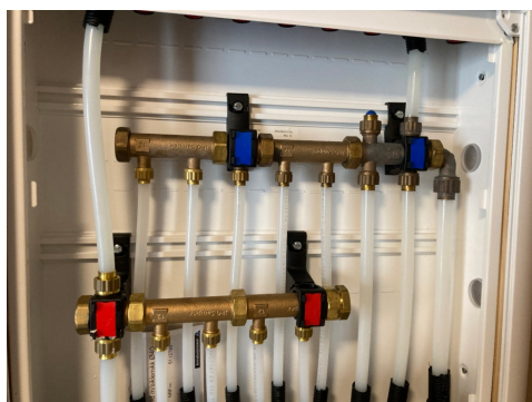
Fordeleskap for rør i rør
