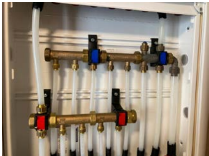
Fordeleskap for rør i rør
