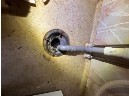
Sluk er plassert under skyllekar.
