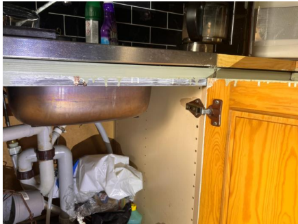
Maling er ikke fagmessig utført.
