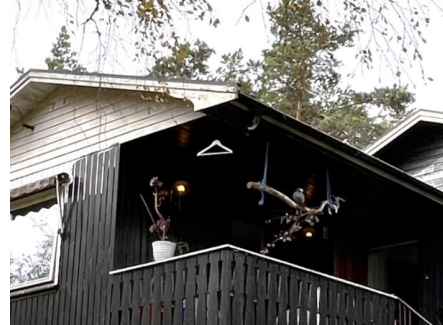
Det er ikke montert taknedløp
