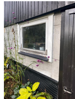
Malingslitt utside av vindu i kjeller.
