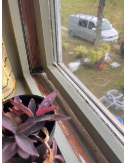
Merker etter kondensvann på kjøkkenvindu
