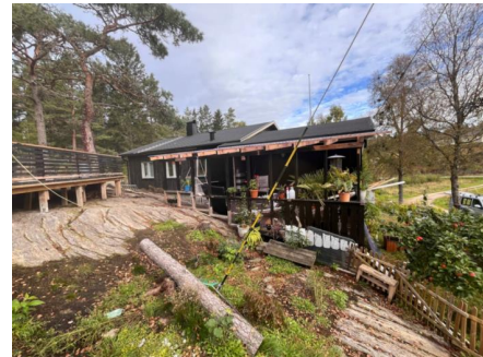
Fall inn mot grunnmur
