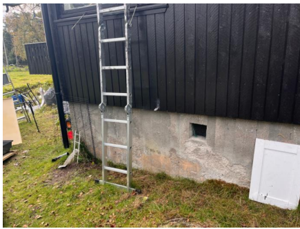
Noe forvitret overflate
