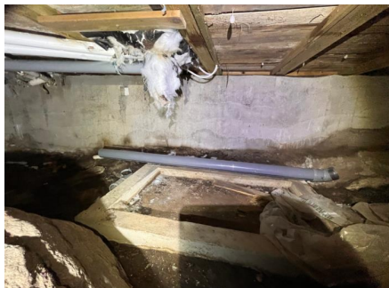
Dårlig tettet rundt rørgjennomføringer
