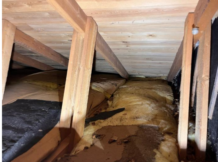
Mangler lufting langs rafter på tilbygget
