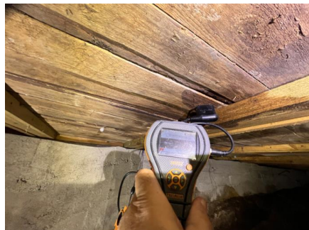
Målt i stubbeloft under bad, 22,2 vekt%
