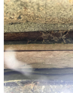
Lite lufting, ikke montert musesperre.
