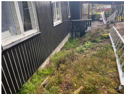
Fall inn mot grunnmur
