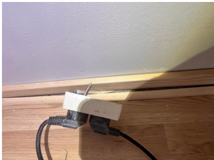
Ufagmessig utførelse, kabel bak gulvlist
