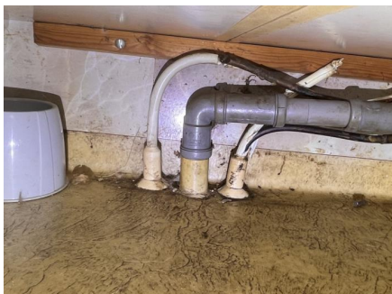
Rørgjennomføringer for servant
