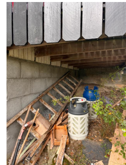
Kraketert maling på vegg under veranda.
