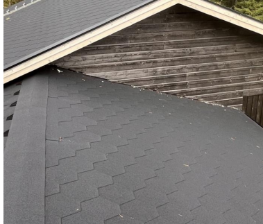
Noe råte på bordkledningen, lav avstand til tak
