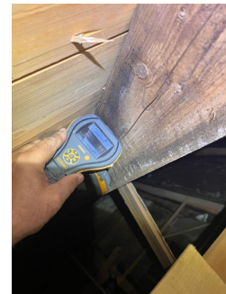
Fuktkontroll på fuktmerker i sperre, tørt nå.
