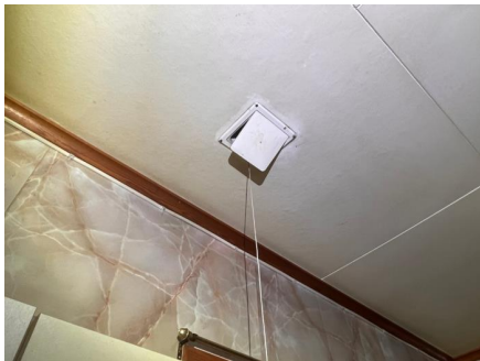
Fuktsvelling i himlingsplate ved ventil.
