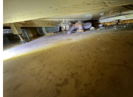
Dusjkabinett er tilkoblet avløp direkte på røranlegget
