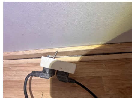
Løs stikk kontakt og kabel bak gulvlist
