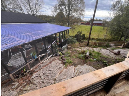
Det er ikke montert takrenner.
