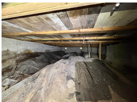
Provisoriske understøtter, fukt innsig langs sørvest side.
