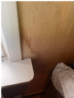
Merker etter fukt ved vindu på soverom mot sørvest
