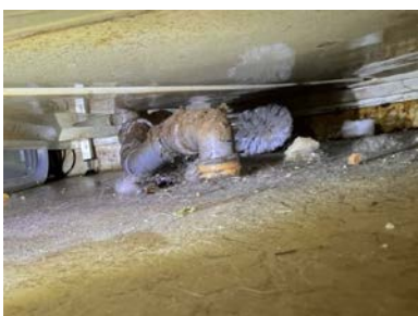
Rørgjennomføring for dusjkabinett
