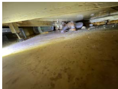
Dusjkabinett er tilkoblet avløp direkte på røranlegget
