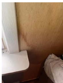
Merker etter fukt ved vindu på soverom mot sørvest
