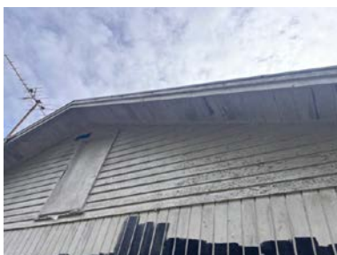
Krakelert maling på nordvest vegg
