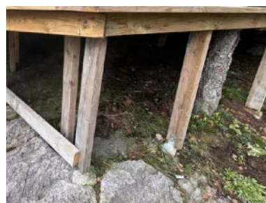
Understøtter på terrasse kun delvis montert på fjell
