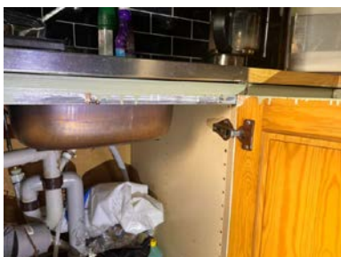
Maling er ikke fagmessig utført.
