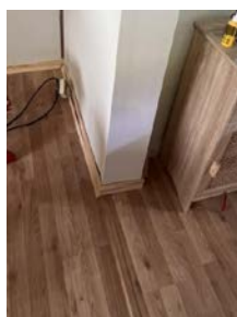
Unøyaktig utførelse, kul/svank på vegg
