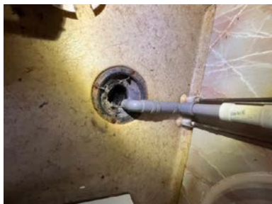
Sluk er plassert under skyllekar.
