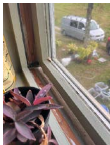
Merker etter kondensvann på kjøkkenvindu
