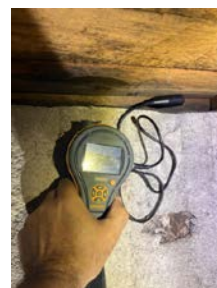
Målt i svill under bjelkelaget, 17,9 vekt%
