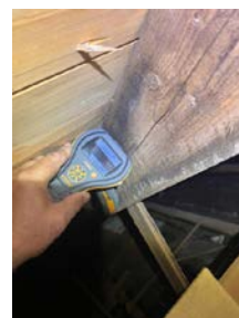
Fuktkontroll på fuktmerker i sperre, tørt nå.
