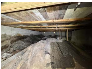
Provisoriske understøtter, fukt innsig langs sørvest side.
