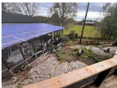
Det er ikke montert takrenner.
