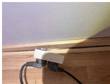
Løs stikk kontakt og kabel bak gulvlist
