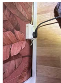
Ufagmessig utførelse, åpning mellom list og vegg
