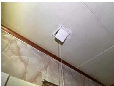
Fuktsvelling i himlingsplate ved ventil.
