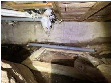
Dårlig tettet rundt rørgjennomføringer
