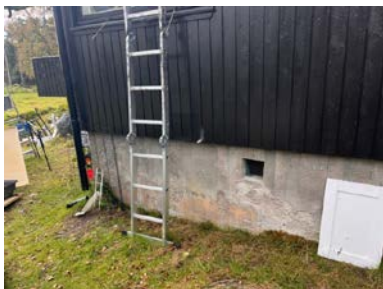
Noe forvitret overflate
