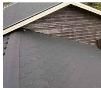
Det er usikkert om det er laget oppbrett på papp bak kledningen.
