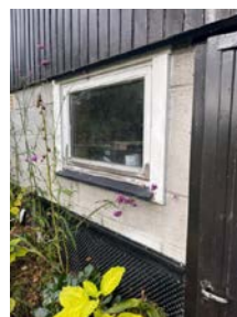
Malingsslitt utside av vindu i kjeller.
