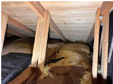
Mangler lufting langs rafter på tilbygget
