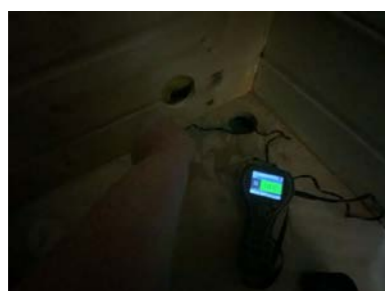
Ikke fukt i oppforet tregulv i garderobeskap.
