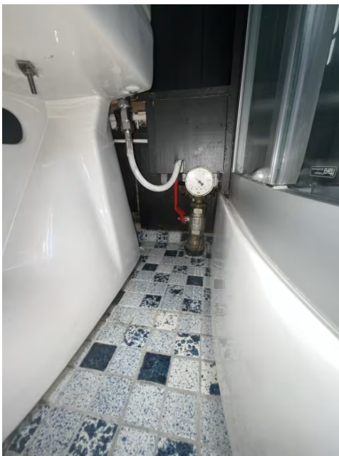
Viser vanninntak og hovedstoppekran plassert på badet.
