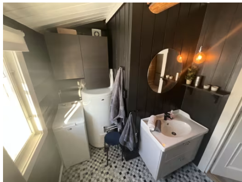
Viser baderomsinnredning, varmtvannsbereder og opplegg for vaskemaskin.
