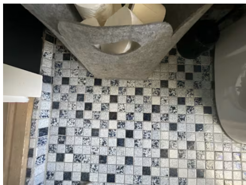
Sprekker og boom under fliser registreres.
