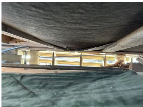
Det er påvist noen stubbloftsplater med utettheter.
