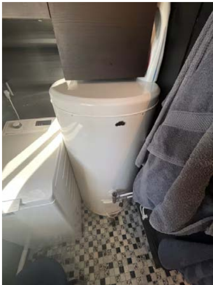
Viser bereder plassert på badet.
