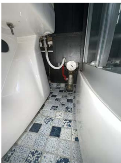
Viser vanninntak og hovedstoppekran plassert på badet.
