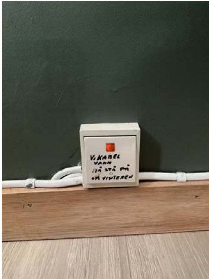
Viser bryter for varmekabel i vannrør plassert langs gulv i spisestue.
