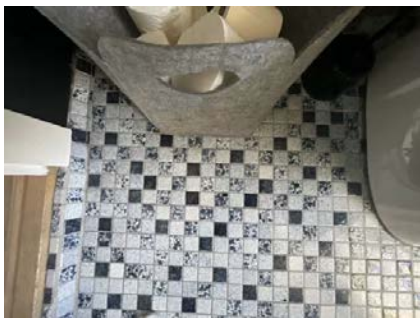
Sprekker og boom under fliser registreres.
