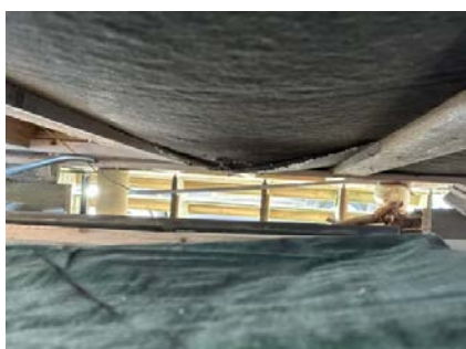
Det er påvist noen stubbloftsplater med utettheter.
