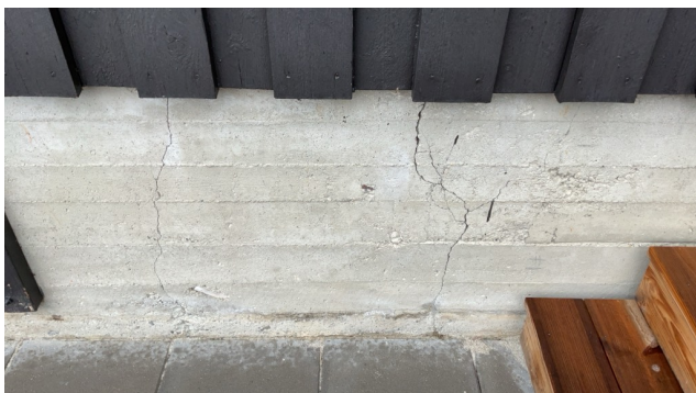
Sprekker på mur
