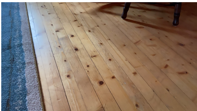
Riper/slitasje på gulv
