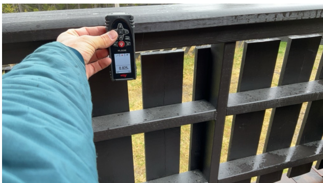
Høyde rekkverk noe under krav
