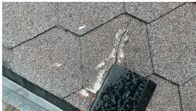
Sprekk i shingel
