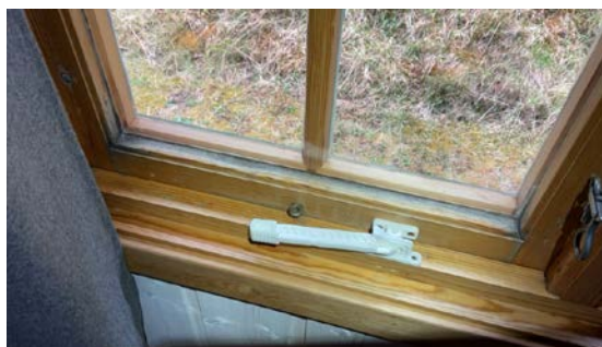
Slitasje i soveromsvindu, nærliggende som følge av kondensering/inneklima
