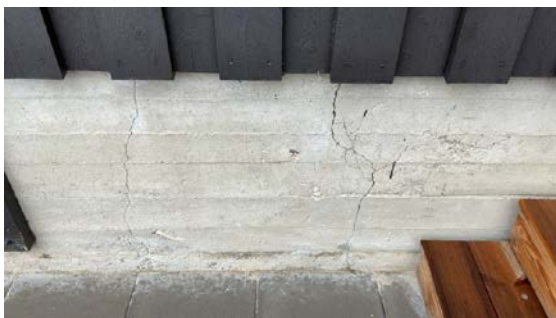
Sprekker på mur
