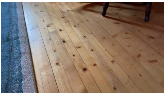
Riper/slitasje på gulv
