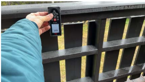
Høyde rekkverk noe under krav
