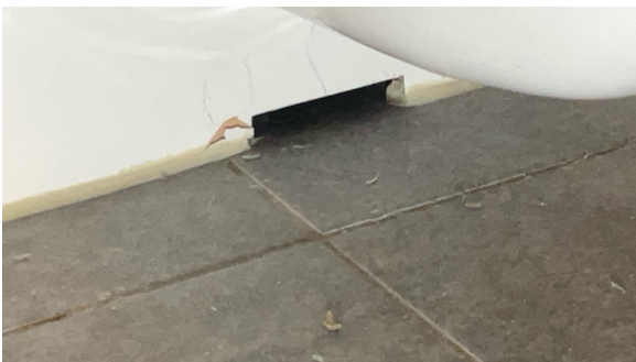
Skader på flis under toalett
