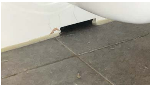
Skader på flis under toalett
