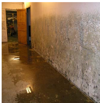
Muggsoppvekst som følge av vannskade
