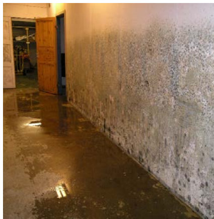
Muggsoppvekst som følge av vannskade
