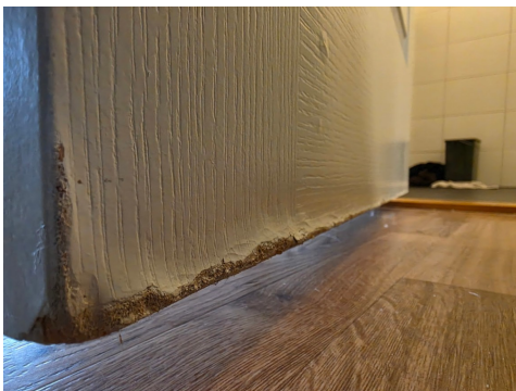
Skader på dør til bad
