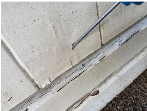
Råteskadet paneler på balkongdør
