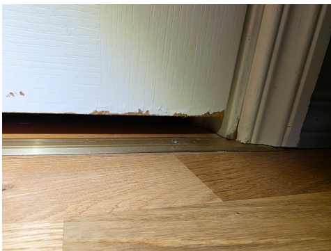
Skader på dør til vaskerom
