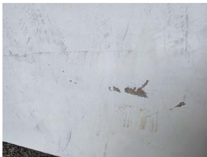
Skader på ytterdør
