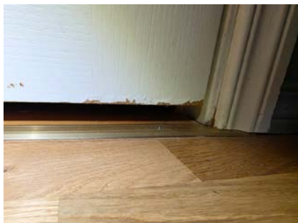
Skader på dør til vaskerom
