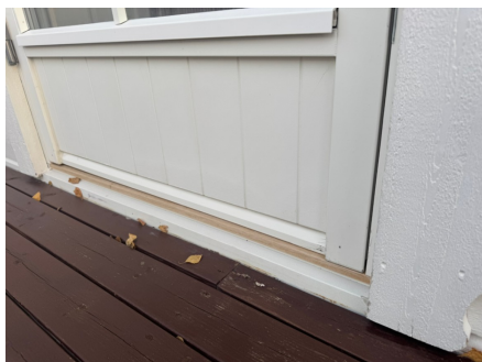
Tegn til påbegynt svelling i døren.
