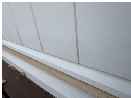
Tegn til påbegynt svelling i døren.
