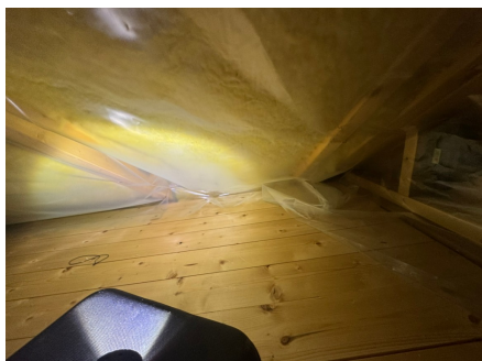
Eksempel på utettheter i dampsperran.
