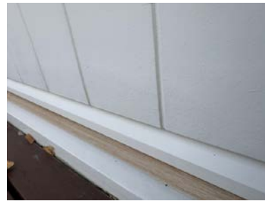
Tegn til påbegynt svelling i døren.
