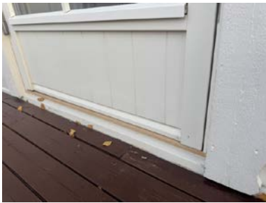
Tegn til påbegynt svelling i døren.
