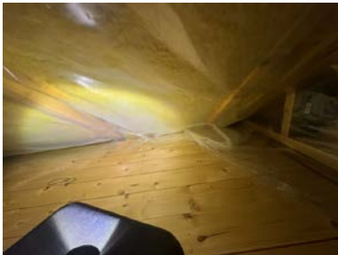
Eksempel på utettheter i dampsperran.
