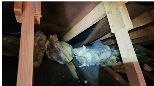
Bildet viser løs sutaksplate i undertaket
