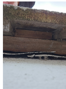
Bildet viser ndersiden av stående kledning. Det er musetettet med lusing. Stuen på kledningen er ikke malt, tedvis noe mykt treverk.
