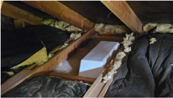
Bildet viser isolasjon i raft, mangelfull isolasjon og åpen bokst til spotlight.
