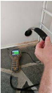
Bilder viser fuktsøk i vegg mot terreng foretatt i vaskerom.
