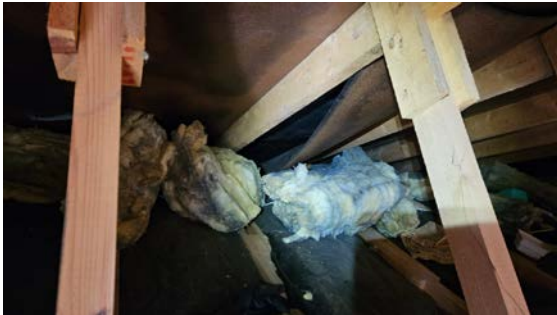
Bildet viser løs sutaksplate i undertaket
