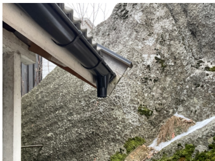
Takrenne som mangler nedløp
