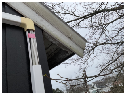
Sverte og grønske på vindskie og kledning
