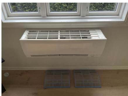
Luft til luft varmepumpe 1. etg.
