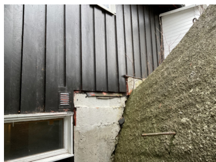
Ufagmessig utførelse av kledning.
