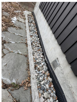
Fuktsikring som har glidd ned fra topplist.
