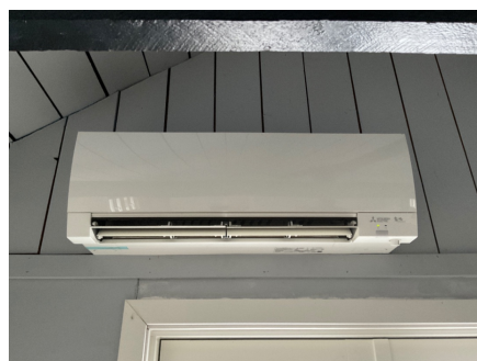
Luft til luft varmepumpe 2. etg
