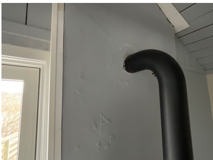
Saltutslag på brannmur og pipe.
