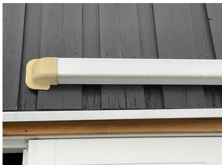
Begynnende råte på kledning over vindu.
