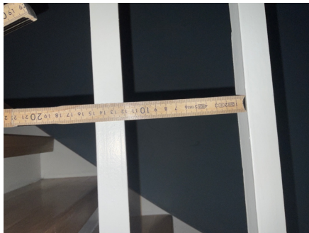
Åpning i rekkverk over 10 cm.
