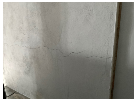
Sprekk i brannmur 2. etg.
