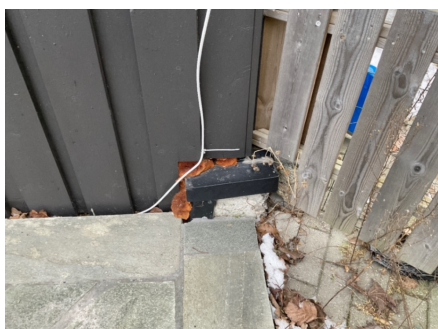
Ufagmessig utførelse av kledning.
