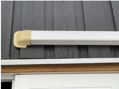
Begynnende råte på kledning over vindu.
