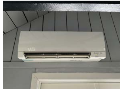
Luft til luft varmepumpe 2. etg
