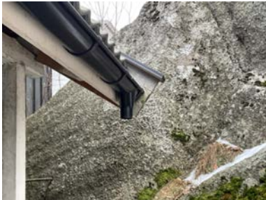
Takrenne som mangler nedløp
