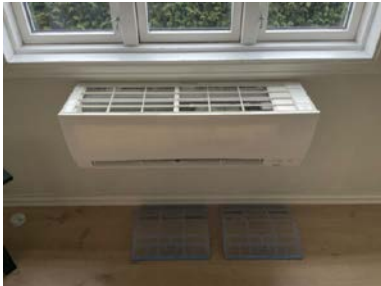
Luft til luft varmepumpe 1. etg.
