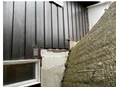
Ufagmessig utførelse av kledning.
