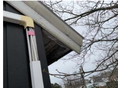
Sverte og grønske på vindske og kledning
