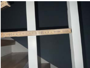
Åpning i rekkverk over 10 cm.
