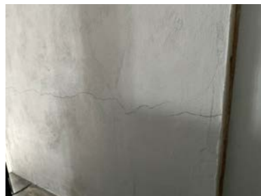
Sprekk i brannmur 2. etg.
