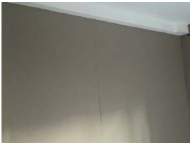
Sprekk i veggplate på soverom 1. etg.
