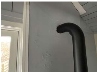
Saltutslag på brannmur og pipe.
