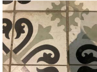
Riss på fliser i gang.
