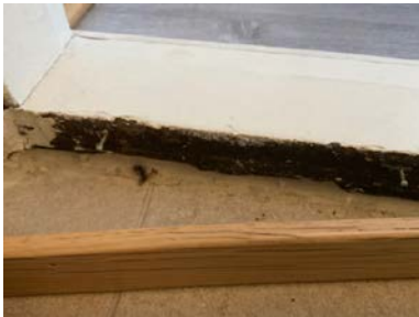
Manglende membran ved oppkant dørterskel.
