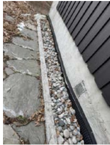
Fuktsikring som har glidd ned fra topplist.
