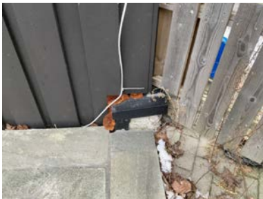
Ufagmessig utførelse av kledning.
