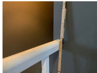
Høyde på rekkverk i 2. etg.
