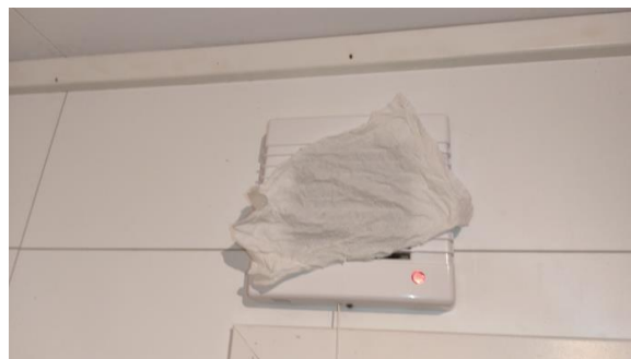
Funksjonstest av avtrekksviften.
