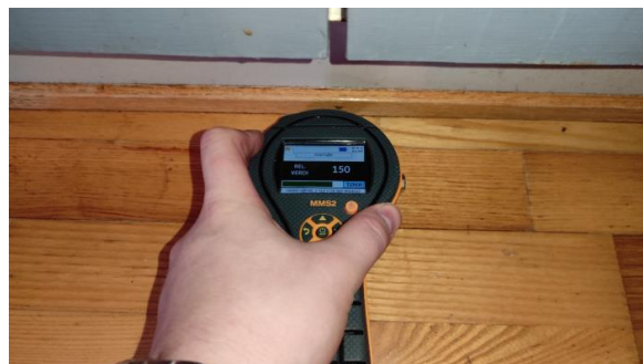
Fuktsøk ved oppvaskkum.
