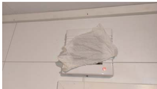
Funksjonstest av avtrekksviften.
